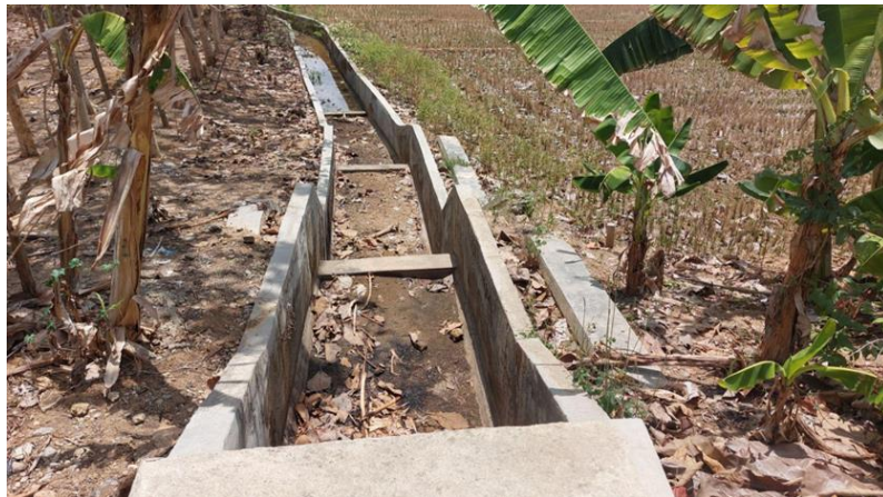
Gambar 1.2 Infrastruktur Pengelolaan Air
